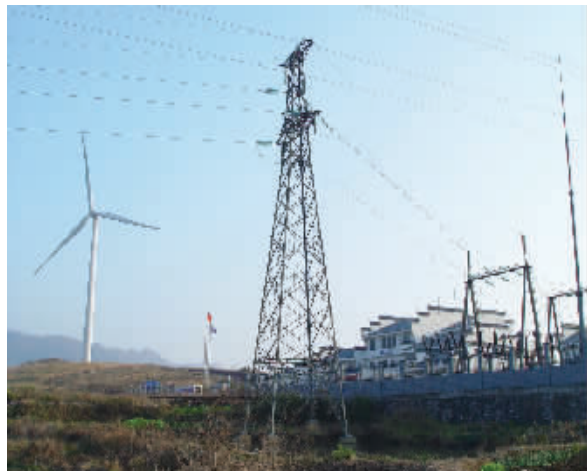
公司承建的湘电新能源鲁荷金风电场110kV线路送出工程
