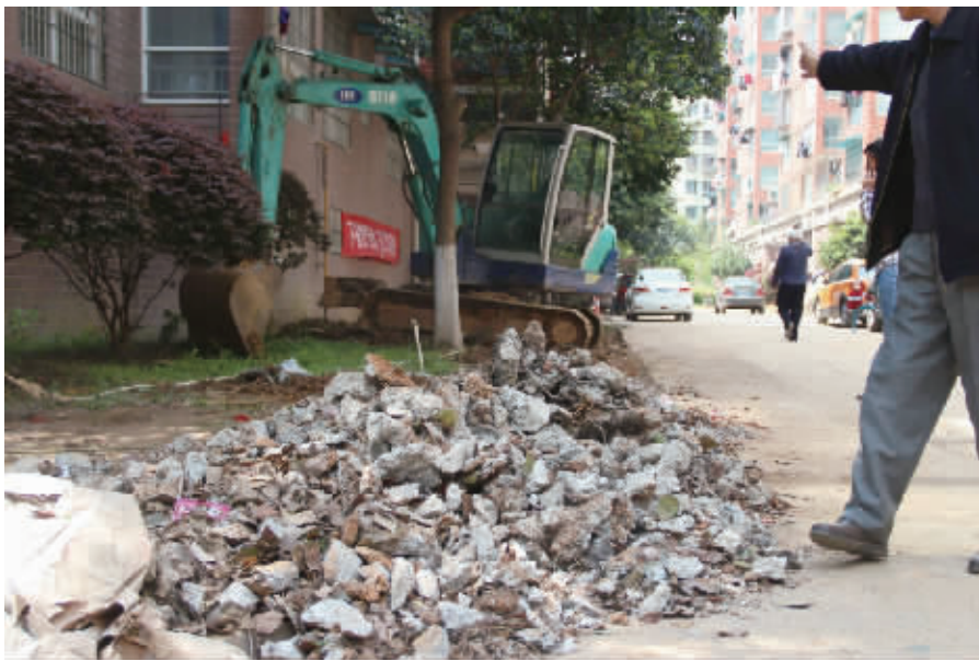
业主指向被挖机破坏的绿化带。
