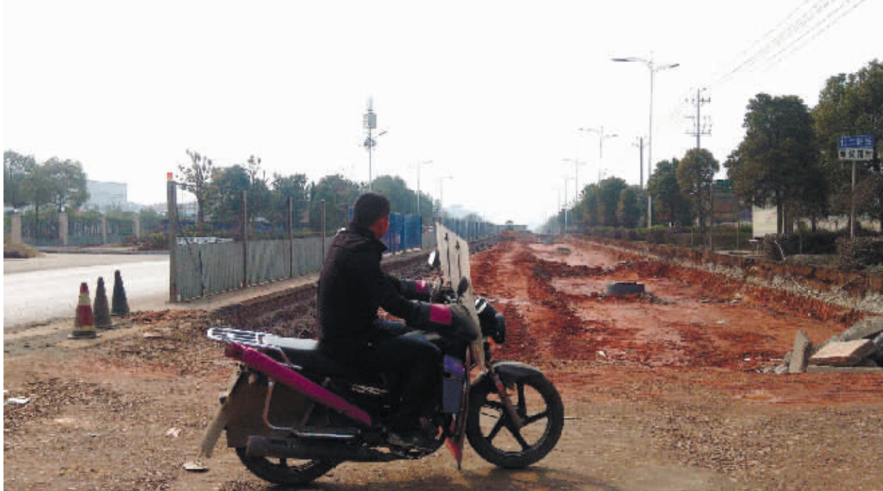
湘潭北二环被护栏隔开,提质改造工程分两部分完成,一边通车,另一边则施工,图为一名摩的司机正在北二环一处路口看施工情况。
