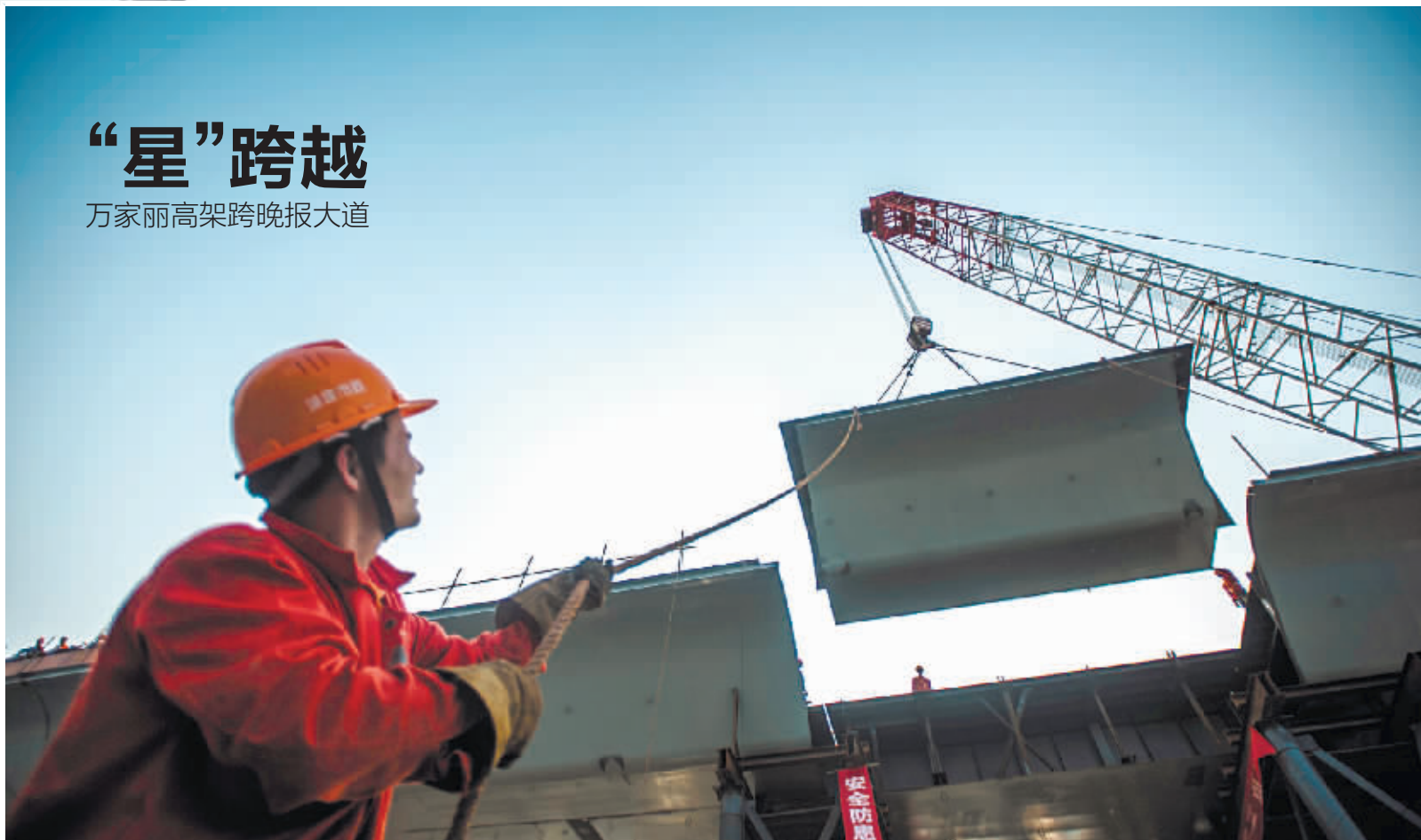
3月30日17时,长沙市万家丽路高架主线跨晚报大道工地,工人在吊装最后一块钢箱梁,并于当晚解除该路段交通管制。该高架桥主线还将在三一大道、火炬路、远大路、人民路、长沙大道、圭塘河、劳动路、香樟路8大路口进行钢箱梁吊装作业,计划在今年8月完成,10月实现高架部分主线通车。 记者 唐俊 摄
