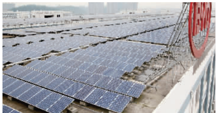
12月9日,长沙市雨花区比亚迪集团光伏发电屋顶。 记者 赵持摄
