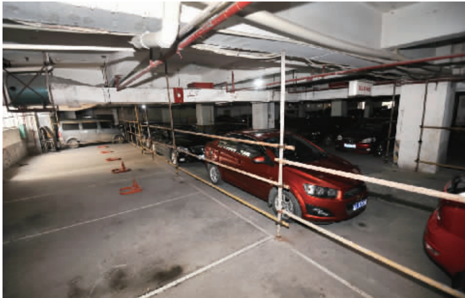
12月2日,长沙市建湘路凤凰大厦地下停车场,很多车位被脚手架围住,一些业主的小车只好停在过道上。 记者 田超 摄
