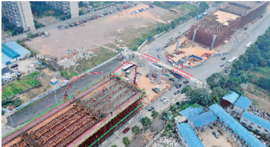
11月18日上午,长沙市万家丽路月湖公园以北段,施工人员开始浇筑高架桥首联箱梁。记者 田超 摄
