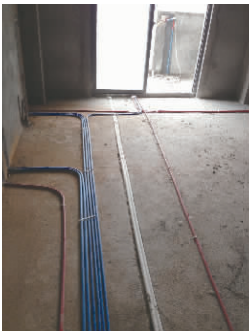
水电铺设不规范容易造成严重的安全隐患。
