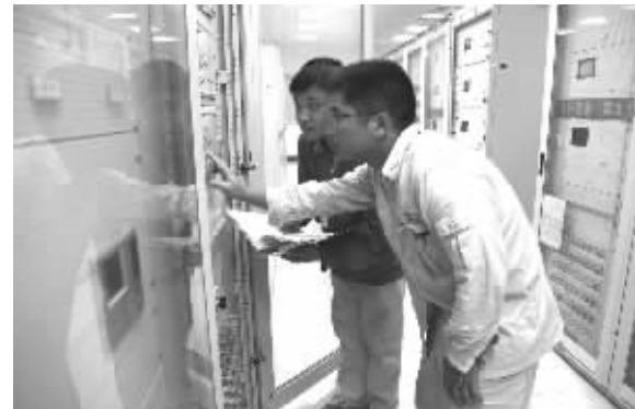
运维人员正在进行设备特巡。
