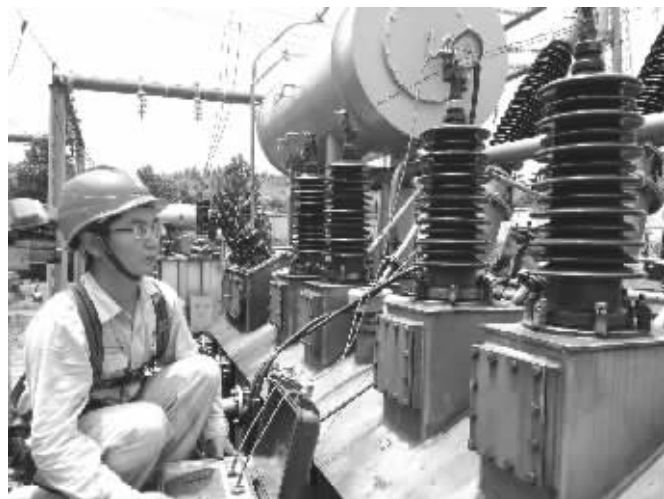
工作人员正进行电网设备检测。
