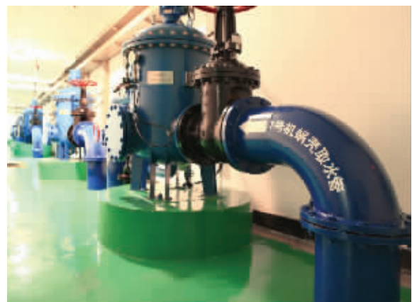
发电厂房干净整洁，设备标示标牌清晰明晰。
