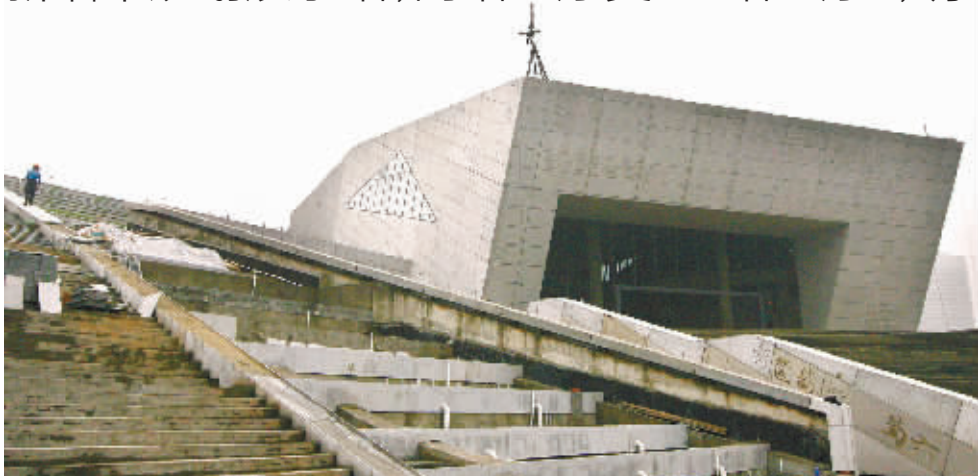
5月20日,工人在加紧建设音乐厅。长沙市音乐厅不同于普通剧院,它不需用任何扩音设备,就能让坐在音乐厅每个位置上的观众享受到同等效果的音乐。 记者 赵持 摄
