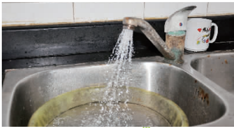
长沙市岳麓区万宝山居民区的陈作舟老人家中安装增压泵后,他再也不用半夜起来接水了。 记者 杨仕凡 摄
