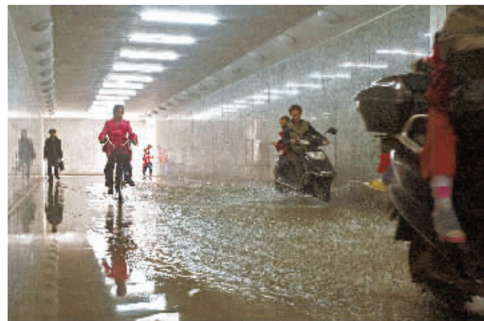
3月31日,位于长沙市金马路与盛世路交会处的地下通道又积水了,近期盛世路正在封闭施工,这条过马路的主要通道如今却成了一条水路。记者 唐俊摄
