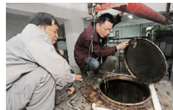
西山汇景小区,物业人员揭开二次供水箱封盖,让小区居民钟先生查看水质。
