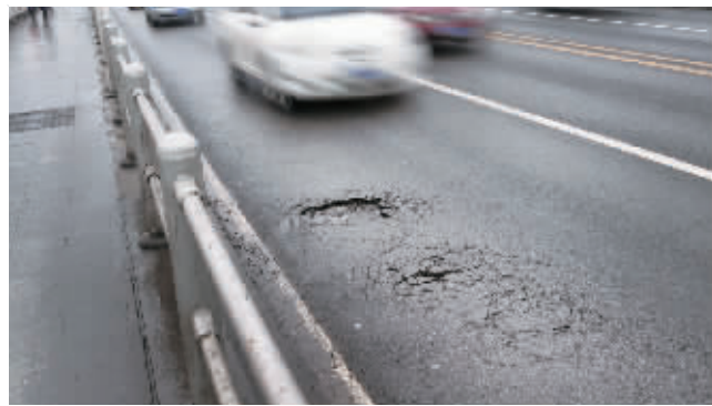
2月18日,长沙橘子洲大桥,去年7月才整修的路面,现在又出现了许多凹陷。 记者 李健 摄
