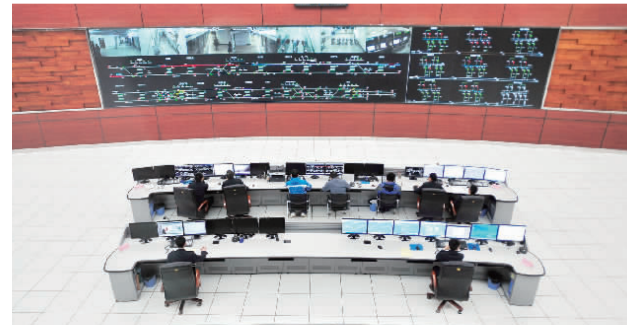
12月19日,长沙地铁2号线控制运营中心,工作人员正在监控列车调试状况。 本版图片均由记者田超 实习生 刘辉宇 摄
