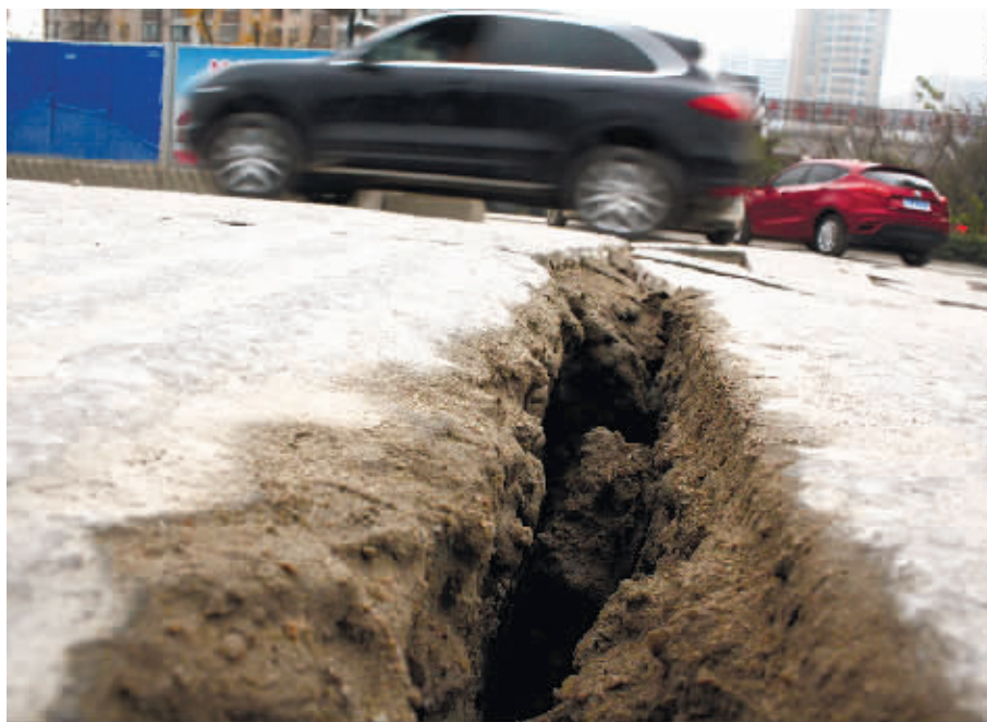
12月18日,长沙市开福寺前,汽车行驶在已是坑坑洼洼的麻石路上,石板与石板之间已经裂开了很大的缝隙。 实习生 何佳乐 摄
