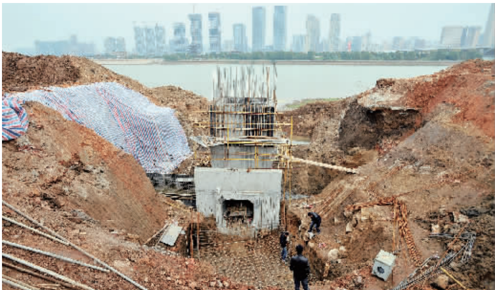
11月27日下午,长沙市潇湘大道溁湾路湘江排水管网改造工地,工作人员正在紧张施工。记者 田超 摄
