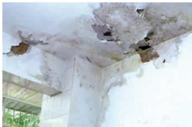
厨房漏水现场。
