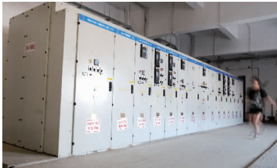
8月8日，位于长沙体育新城的游泳中心变电站通电，地铁2号线实现“电通”。记者 龚磊 摄
