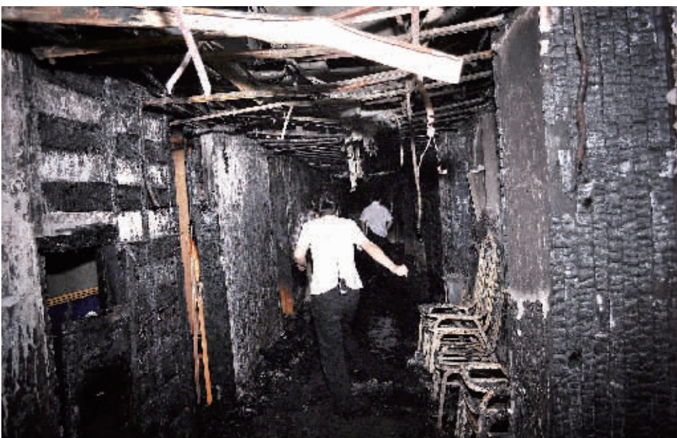
6月12日傍晚,长沙市芙蓉区解放路与曙光路交叉口一酒店4楼发生火灾,过火面积约40平方米,火灾造成3人受伤,已送往医院进行救治,无生命危险。 实习记者 李健 摄
