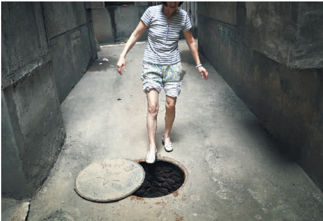
6月5日,长沙开福区吉景小区3栋内巷,王女士说,“当时看似好好的井盖,脚一踩却突然翻了。” 实习记者 李健 摄
