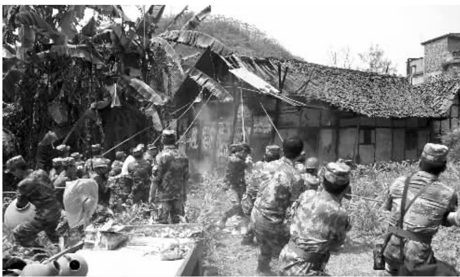
4月27日，成都军区驻川某工兵团在宜宾市长宁县双河镇大户村拆除一座老旧危楼。新华社图
