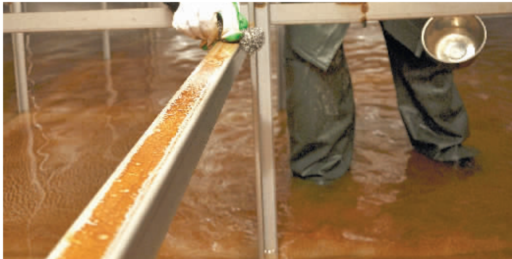
长沙市某小区的二次供水蓄水箱, 上面有一层厚厚的锈垢。 实习记者 唐俊 摄
