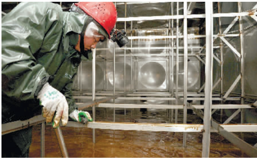
长沙市某小区,专业人员在清洗二次供水蓄水箱,锈水横流。 实习记者 唐俊 摄
