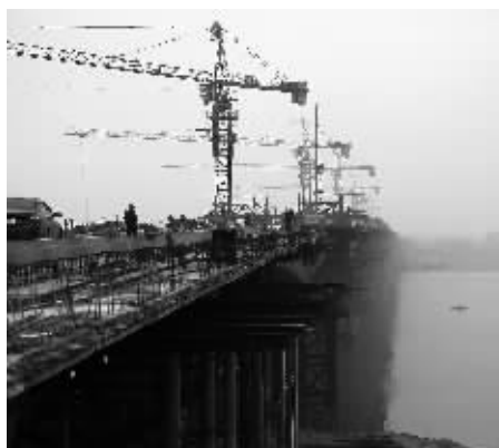
12月28日,长沙市湘府路湘江大桥,引桥的最后几十米正在接合。
