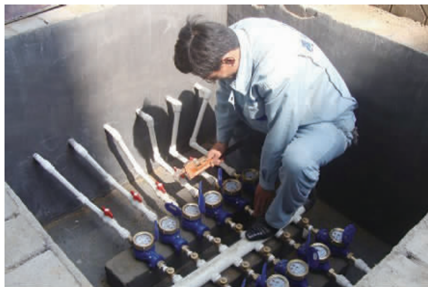
长沙市相当多的楼栋还是使用总水表,“一户一表”改造难度仍大。(资料图片)
