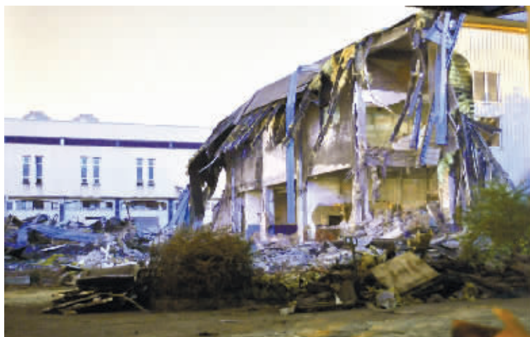
火灾过后，厂房被烧得“面目全非”。
