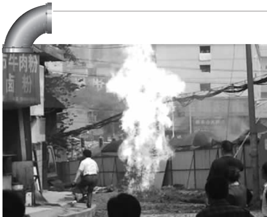
10月21日中午11时30分左右,长沙青园路农业机械研究所前天然气管道被挖破,燃起大火。 (网友供图)
