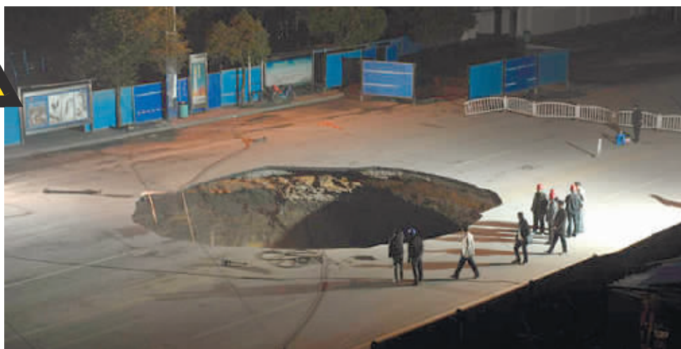
2010年11月29日晚,长沙营盘路过江隧道施工路段路面发生塌陷。
