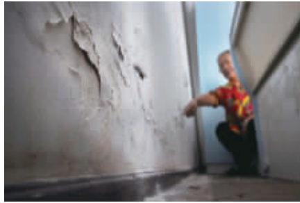
长沙市永宏佳园小区2栋3单元张女士家,因墙壁渗水导致卧室墙面大面积剥落。实习生 李健 摄
