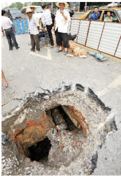
▲香樟路路面塌陷的大坑，引来许多路人张望。 记者 童迪 摄
