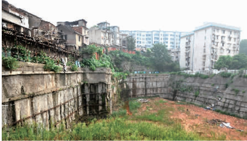
▼位于长沙市劳动广场附近的澳洲购物城大基坑，由于一直没有动工，导致周边房屋多处开裂。 记者 田超 摄
