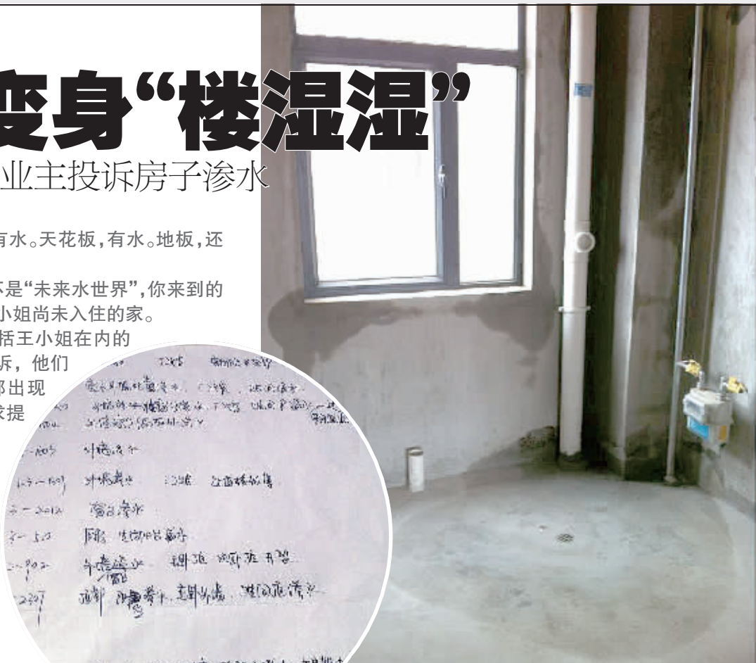
▲新房漏水实景图。 ▲湘水熙园开发商登记 的诸多业主房屋问题。
