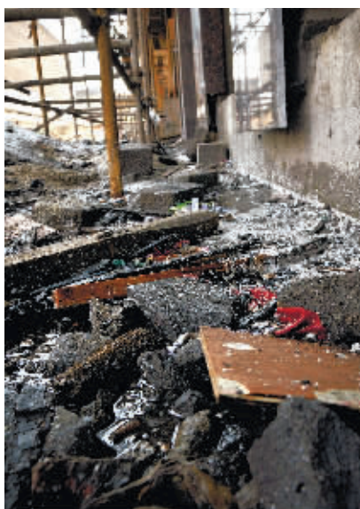
7月4日,长沙东岸城邦楼盘,灭火后的场景。实习生唐俊 摄
