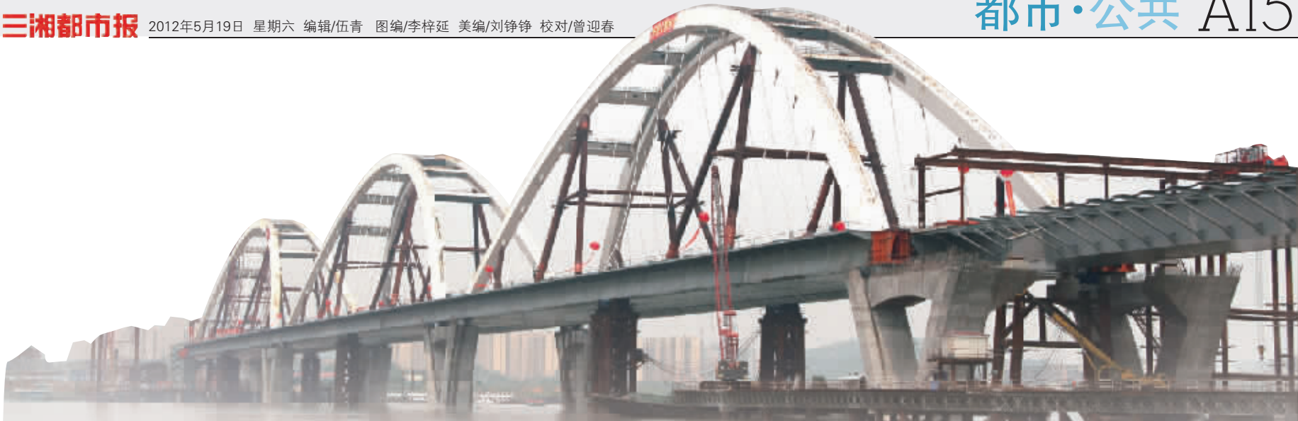
历经170个日夜施工,福元路湘江大桥河西主桥与河东引桥终于合龙。 通讯员 翟德润 摄
