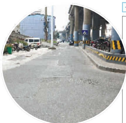
4月9日,东风路高架桥下,路面到处是“补丁”。
