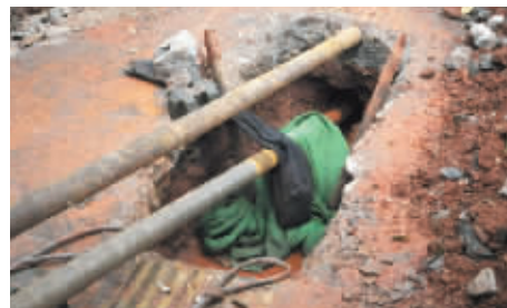
3月30日，长沙新建西路二十一中门口，地下天然气泄漏。 实习生 李健 记者 李丹 摄
