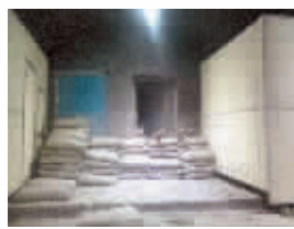
隧道安全通道里摆放着用来补漏的水泥。 记者 李丹 摄
