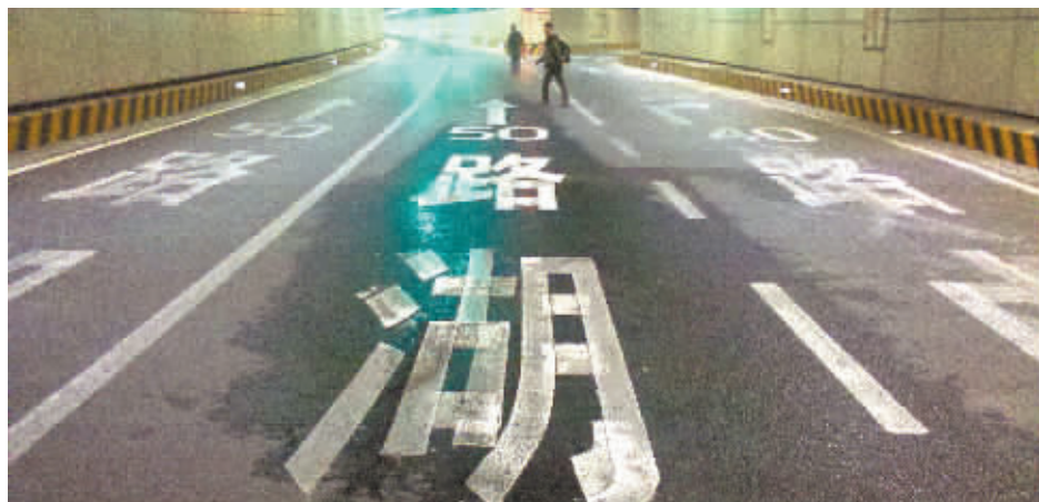
2月23日凌晨，营盘路湘江隧道西交叉口，渗漏水的湿渍绵延数十米。 记者 李丹 摄
