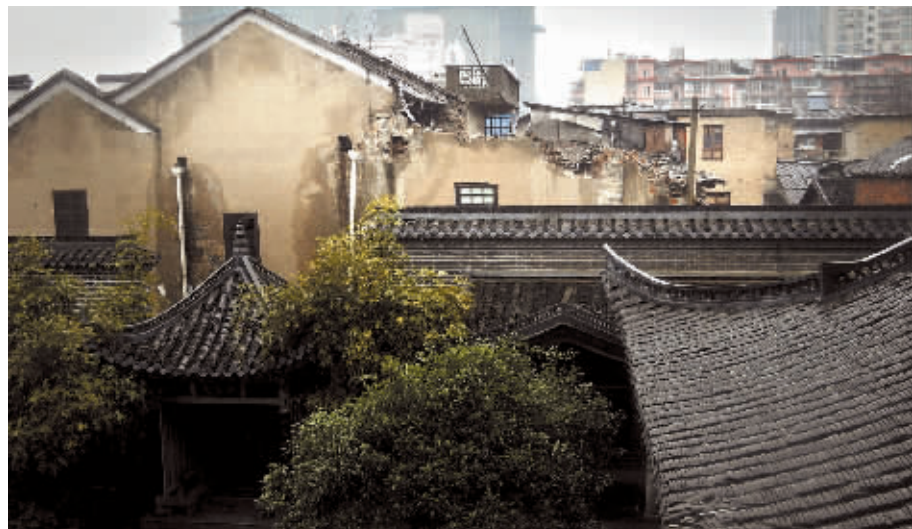
3月4日，长沙市太平街，贾谊故居旁一居民楼顶层垮塌。 实习生 李健 记者 李丹 摄
