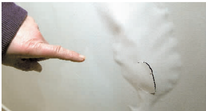
长沙市长盛岗亭小区西一栋1702房，业主指出被水浸坏的墙壁。记者 龚磊 摄
