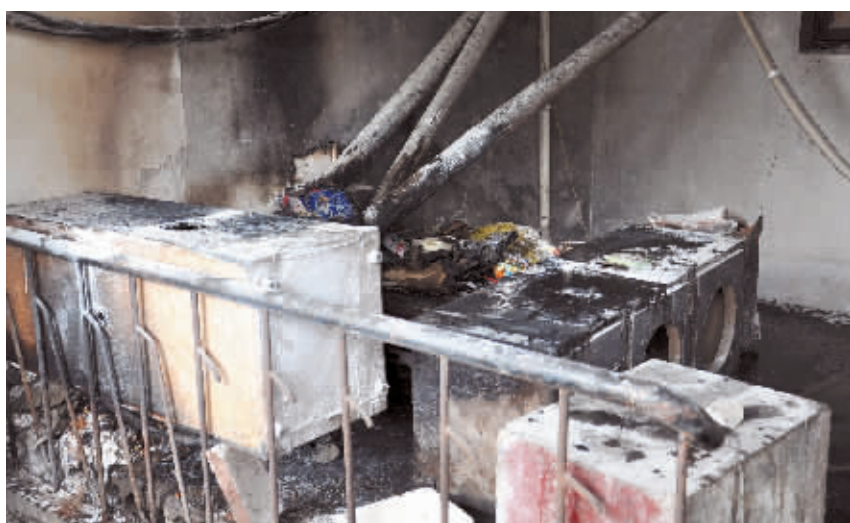
1月12日，长沙市砂子塘湖南中医药大学运输服务中心一居民楼二楼的楼梯间内，一小孩玩打火机，不小心点燃泡沫，引起大火。 记者 王翀鹰 摄
