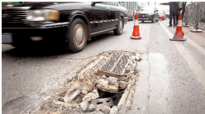
1月10日,长沙五一西路,过往车辆小心避让被压坏的水下水道井盖。记者 范远志 摄
