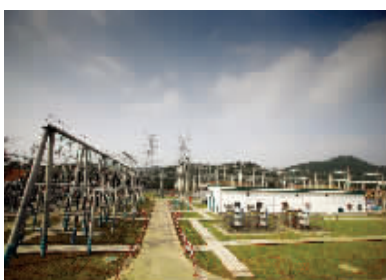
公司承建的输变电项目——醴陵北220kV变电站。
