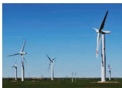
公司承建的风电机组。
