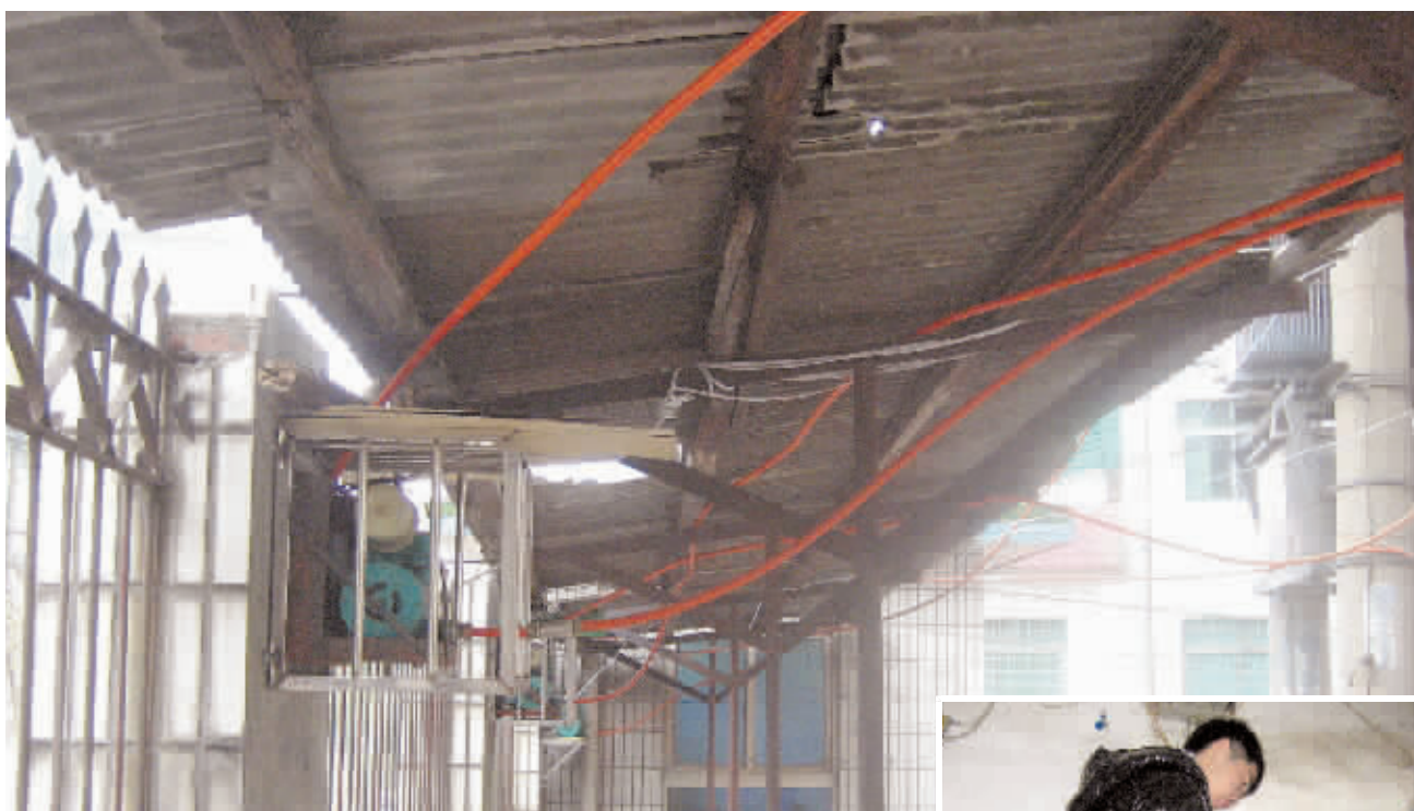
无奈的高层住户,只得自己装水泵,橙黄色的水管就是私接的水泵。 记者 李琪 摄
