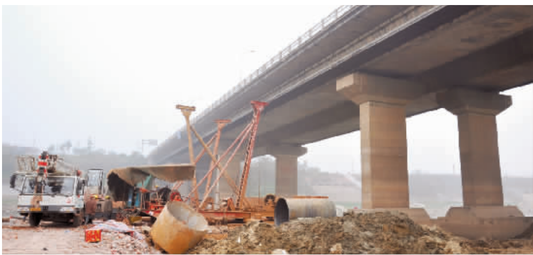
11月29日,长沙市芙蓉北路浏阳河桥北边,十多名工人正在做浏阳河堤坡,新桥的位置就在他们工作的上方。新桥建成后,将与老桥各司其职,一座专供北行,一座专供南行。 实习生 蒋璐 记者 王种鹰 摄
