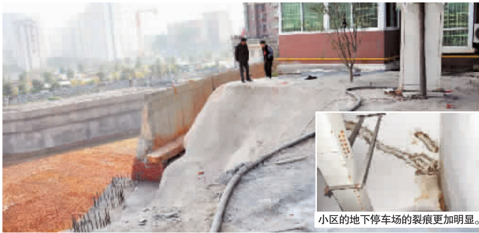
11月24日,长沙市岳麓区金星中路格林星城,业主们都猜测出现的裂缝和紧挨小区的在建工地有关。实习生 蒋璐 记者 王翀鹰 摄
