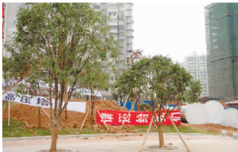
11月7日,在高压电塔施工现场,高压线就是从图中两栋楼间穿过。 记者 刘璋景摄
