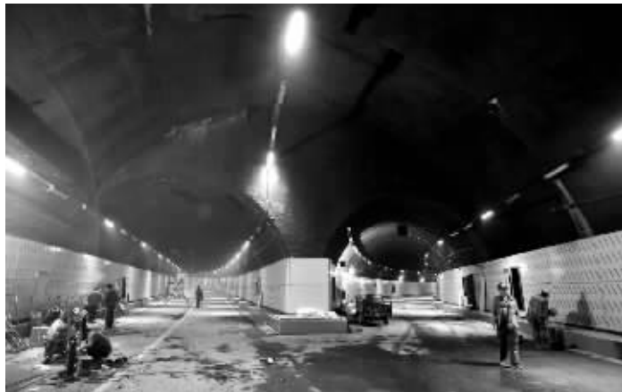
隧道主线和匝道分岔口处,在施工过程中,该处一个断面需要171道工序,创造国内之最。现工人们在做最后的清理扫尾工作。
