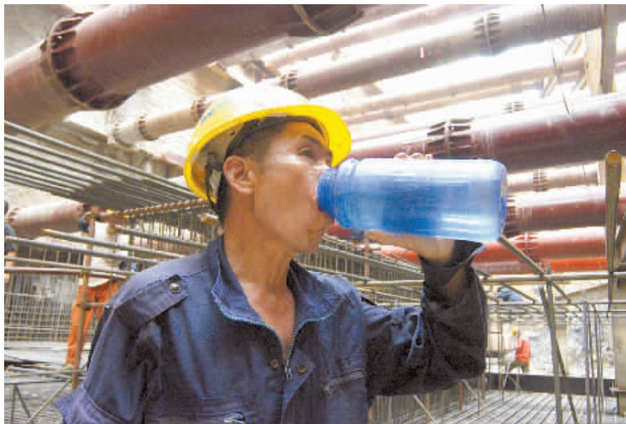
7月19日,长沙地铁五一广场段施工现场,能装三四斤水的大水瓶,工人们一天起码要喝两大瓶。本版图片均由 记者 王翀鹰 摄
