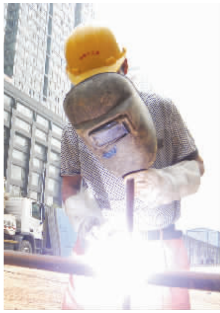
甘行春正在焊接护栏。因为太热,连续工作一段时间就要休息一下。
